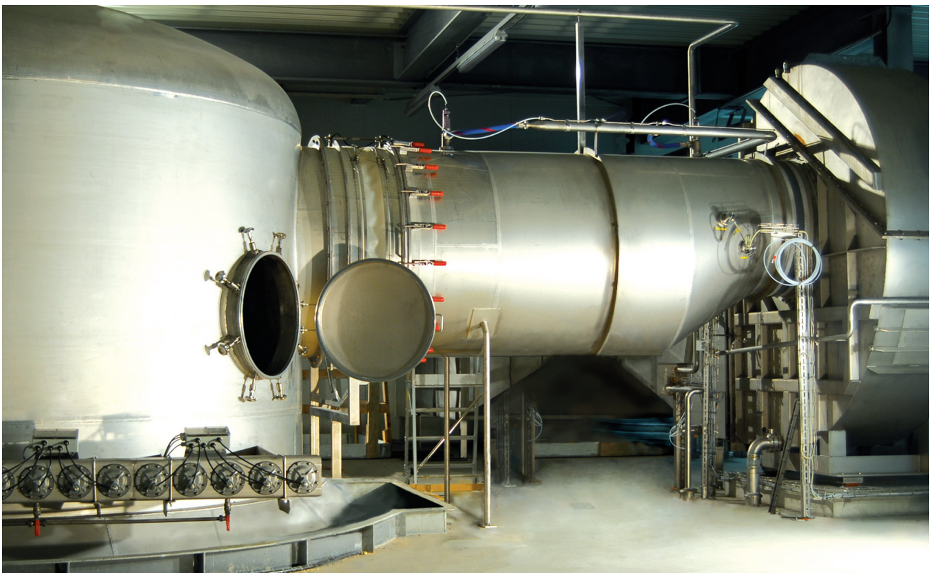
Mit der CIP-Filteranlage lassen sich Betriebskosten senken und Erträge steigern
